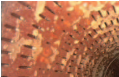
Abb. 7 Gereinigter Steinzeugbrunnen mit Beschädigungen der Glasur, verursacht durch ein unkontrolliertes Wasserhochdrucksystem
